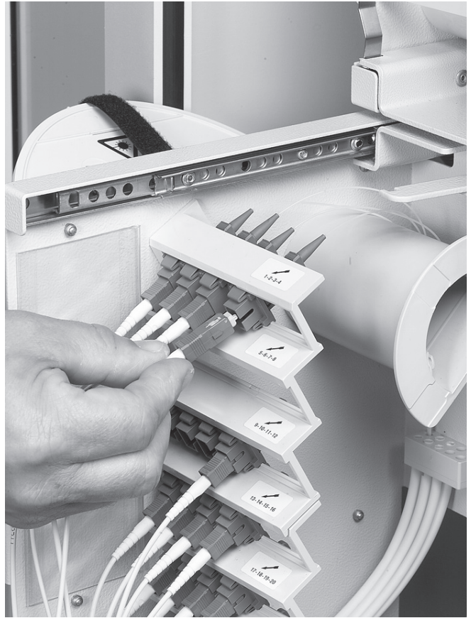
6.1.1 Patchkabel in die Kupplung einstecken. Bei den unteren Positionen etwas Spiel im Kabel belassen, damit alle Positionen beim späteren Umpatchen erreicht werden können.
